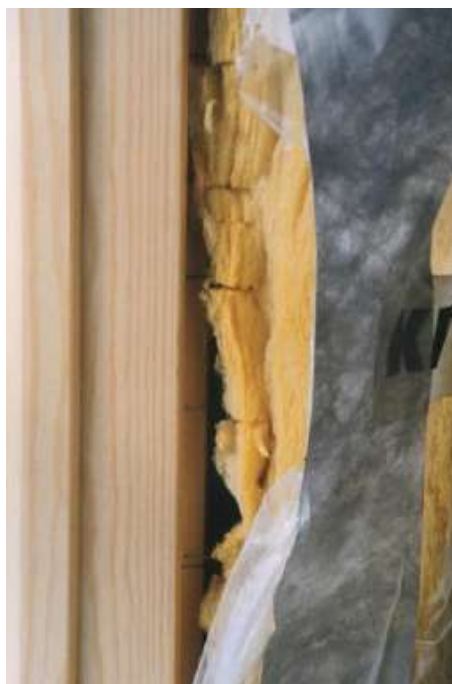
Mangelhafte Ausführung der Luftdichtheitsschicht. Die Folie hat sich vom Rahmen gelöst.
